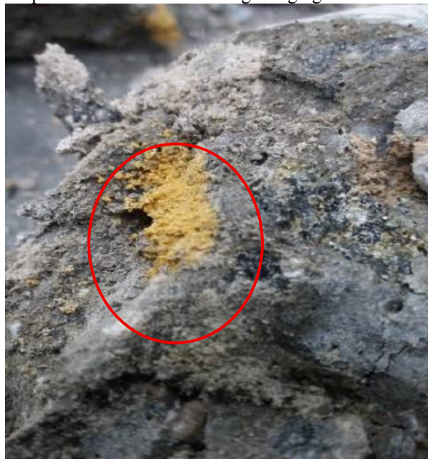
Figura 5 – Aspecto arenoso oriundo de algum agregado do concreto reciclado
